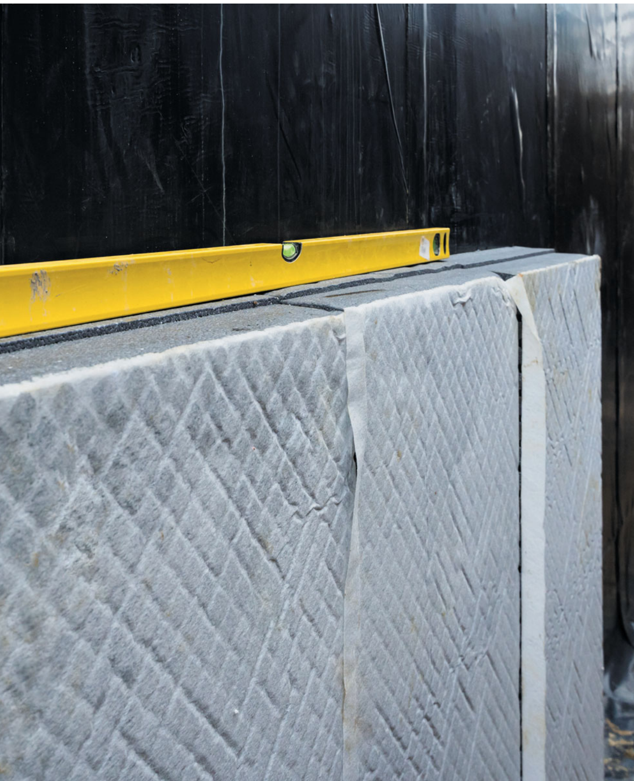
Collage des panneaux Knauf Therm Perimaxx sur le revêtement d'étanchéité d'un mur enterré
